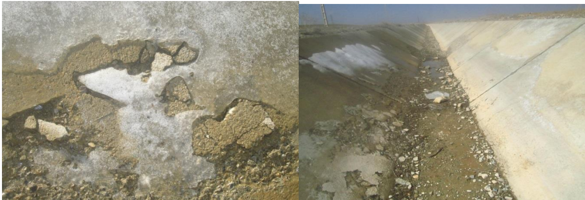
شکل ۱- تاثیر تدریجی پدیده یخبندان-ذوب متناوب در تخریب کانال آبیاری سیاه‌کمر در منطقه سردسیر همدان
