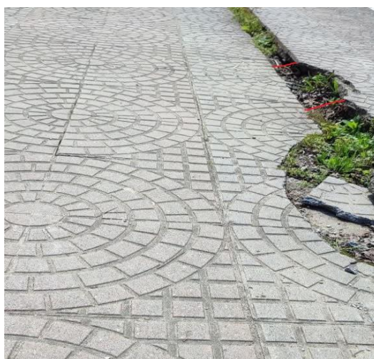
شکل ۱۱- ترک خوردگی و نشست پیاده رو در محدوده سراجه
